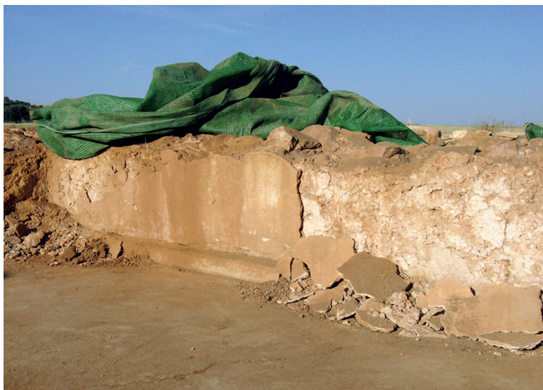
Derrumbe de los enlucidos que recubren los paramentos de la estancia 9.
