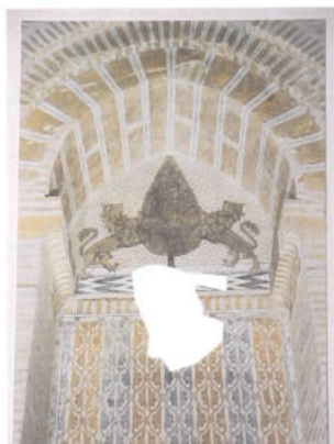
PÉRDIDA DE RITMO POR FALTA DE ELEMENTOS DE REPETICIÓN
