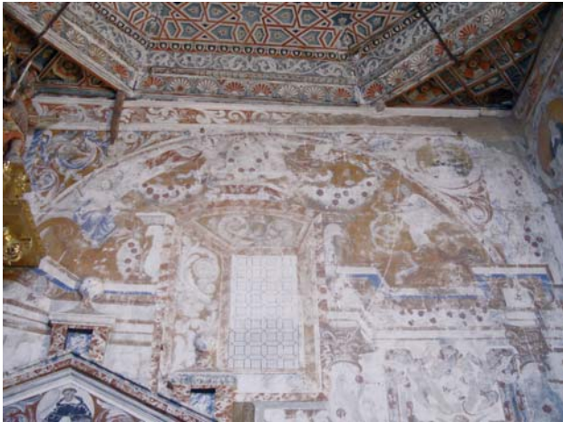
Detalle del mural antes y después de la restauración. La saturación y reintegración de faltas hace recuperar la obra con toda su fuerza pictórica.
